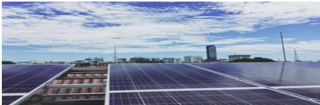
Hình 6. Lắp đặt Điện mặt trời mái nhà tại một khách sạn ở TP. Huế
